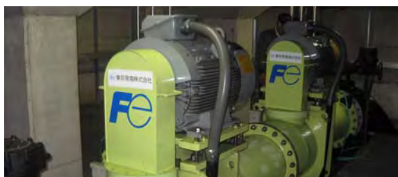
地下室にあるマイクロ水力発電の設備
