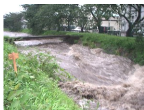
大雨が降ると濁流が 溢れそうになる 2002.8.5
