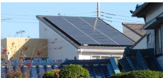
太陽光パネル
